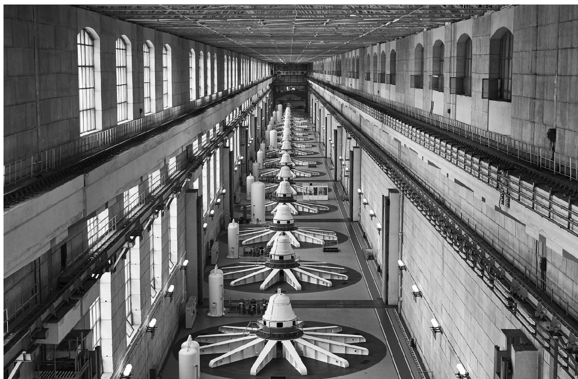
■ Это машинный зал, где располагаются 20 гидроагрегатов. Когда поднимаешься вверх дух захватывает от открывающегося вида
